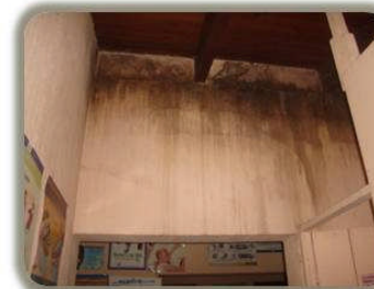
FOTO: No. 6 Los muros se encuentran en malas condiciones debido a filtraciones. Toma y Diseño: Propio
