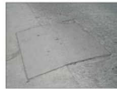
FOTO 2 Vista de la caja de drenajes (colector municipal) ubicada frente al terreno
