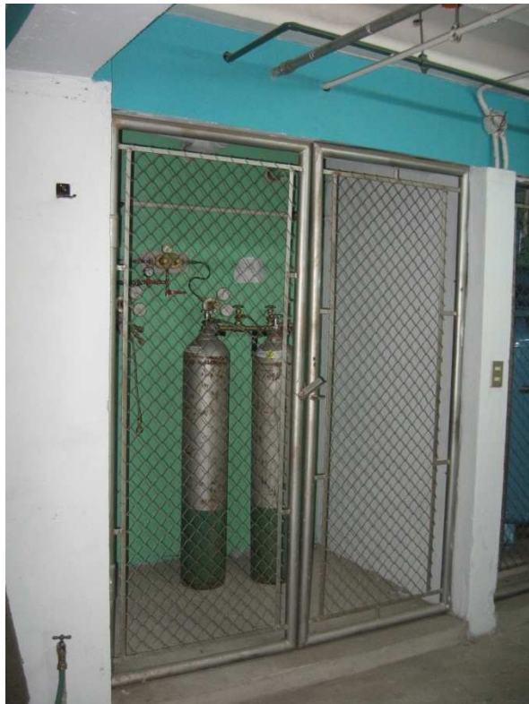
Foto No. 41 ÁREA DE CILINDROS DE OXÍGENO
