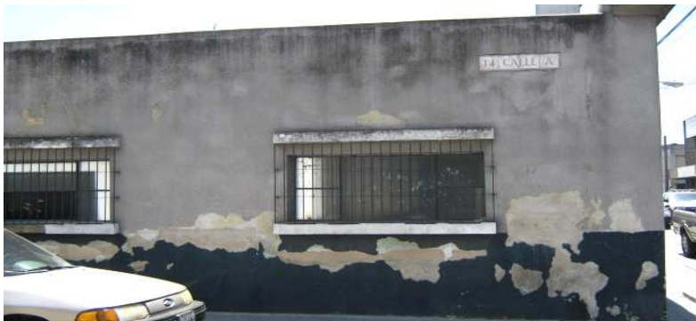
Fotos 90 y 91 se observa el mal estado de las paredes exteriores Antigua comisaría No.11, 14 calle “A” y 11 Av. Fuente: Elaboración propia
