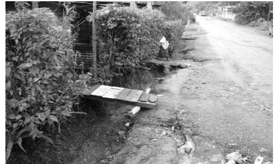
FOTOGRAFÍA No. 15 EROSIÓN POR FALTA DE DRENAJES
