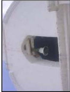
Fotografía No.1 Detalle de la campana del Templo Católico de Santa Cruz la Laguna se observa desprendimiento de los materiales, así como hongo en la madera donde se encuentra colgado la campana.
