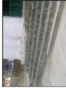
Fotografía No.4 Desprendimiento de materiales en gradas principales del Templo Católico
