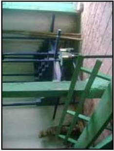
Fotografía No. 27 Deterioro del mobiliario interior del Templo.
