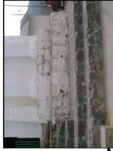
Fotografía No.7 Desprendimiento de materiales en gradas principales del Templo Católico
