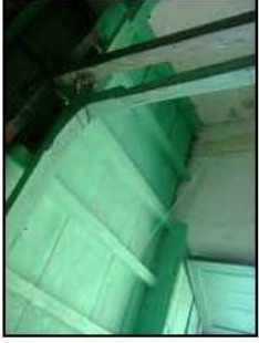
Fotografía No. 29 Deterioro en la madera causado por la polilla y la humedad en la pared se observa humedad y filtración de agua provocando desprendimiento del material.
