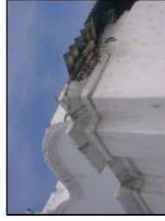
Fotografía No.5 Notese en los contrafuertes del Templo Católico que hay desprendimiento de material y vegetación por lo que genera un deterioro progresivo.
