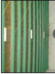
Fotografía No. 22 En la fotografía se observa que el interior del Templo hay deterioros en su elementos que lo componen.
