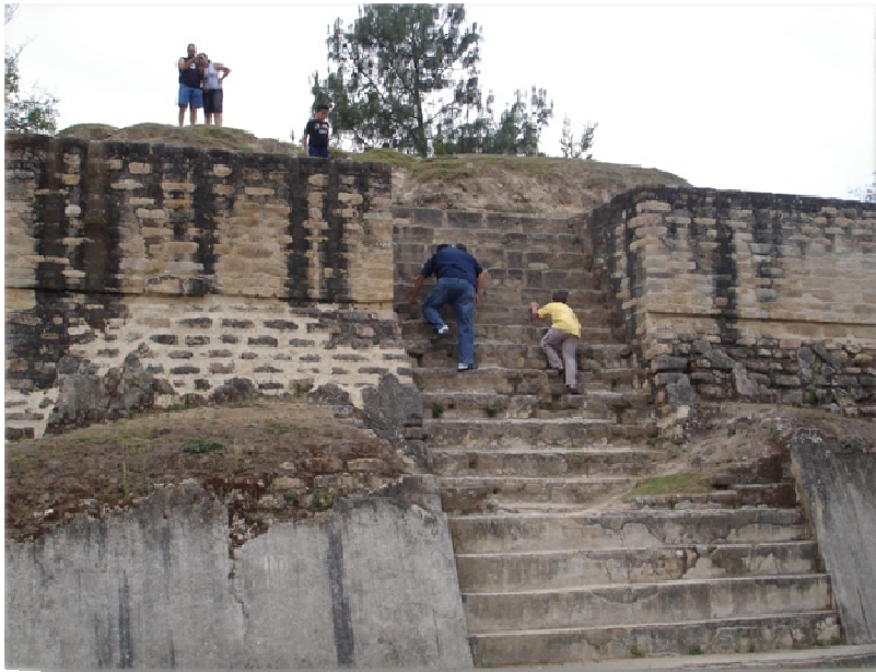
Fotografía No. 2 Daños ocasionados por turistas a los edificios. 16
