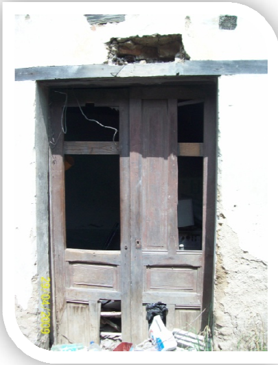
Deterioro en puertas a causa de factores climáticos y contusiones.
