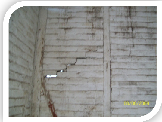
Fisura en paredes del segundo nivel a causa de factores ambientales.
