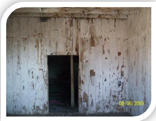
Acumulación de humedad y plagas en los tabiques del interior del segundo nivel.
