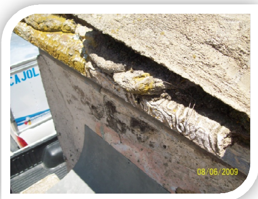
Desprendimiento de acabados en cornisa del primer nivel.
