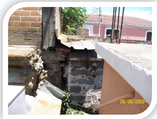
Fisura en uniones de contrafuertes a causa de factores ambientales.
