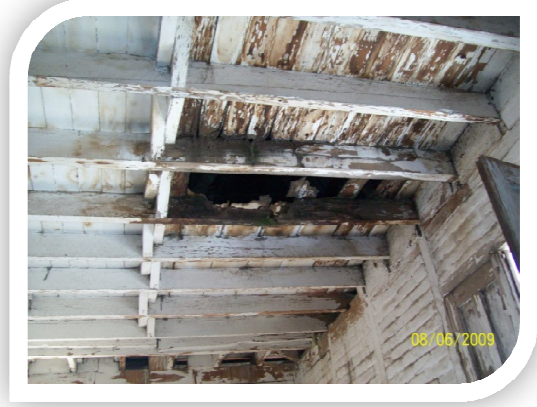
Acumulación de humedad y plagas en el entrepiso del segundo nivel.
