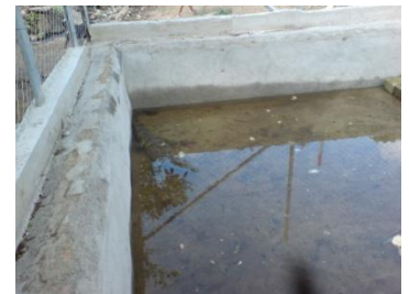
Falta de mantenimiento del área del cocodrilo
