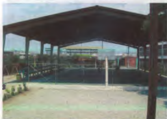
Foto N° 15 Estado actual de la cancha Techada . Fotografías: Elaboración propia.
