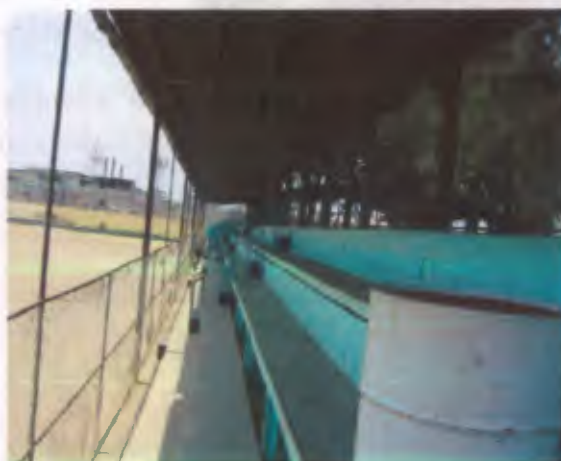
Foto N°17 Se observa que el graderío está deteriorado por la falta de
