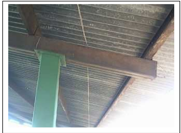
Fotografía No. 13. Unión entre columna y viga metálica, se observa el deterioro en estado de oxidación de las costaneras y vigas, mas no así el estado actual de las columnas las cuales recientemente han tenido mantenimiento.
