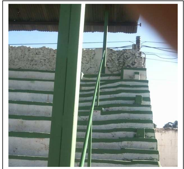
Fotografía No. 9. Vista frontal de las gradas de la tribuna principal, las cuales son las mas utilizadas por los aficionados, por su proximidad al parqueo, sin embargo tienen baranda únicamente de lado izquierdo y no al derecho, de manera que se torna inseguro a medida que se asciende por ellas.
