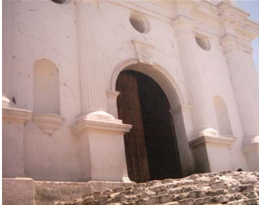
Imagen 33. Alteración en muros fachada. Fuente: Fotografía propia.
