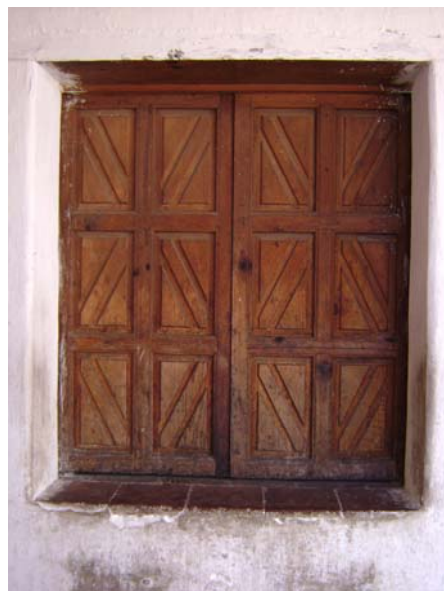
Imagen 41. Ventana hecha similar a las originales. Fuente: Fotografía propia. Archivo Fotográfico Ejercicio profesional Supervisado 2008-2009.
