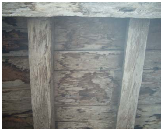
Imagen 37. Madera alterada en pasillo. Fuente: Fotografía propia. Archivo Fotográfico Ejercicio profesional Supervisado 2008-2009.
