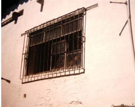
Imagen 43. Ventana alterada en el convento. Fuente: Fotografía propia. Archivo Fotográfico Ejercicio profesional Supervisado 2008-2009.
