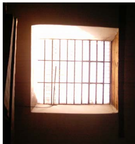
Imagen 42. Ventana alterada en el convento. Fuente: Fotografía propia. Archivo Fotográfico Ejercicio profesional Supervisado 2008-2009.
