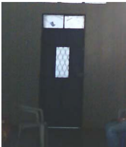
Imagen 47. Alteración en puerta del convento. Fuente: Fotografía propia. Archivo Fotográfico Ejercicio profesional Supervisado 2008-2009.
