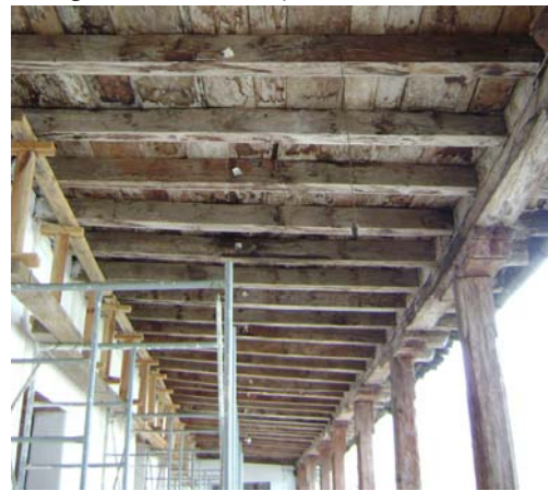
Imagen 38. Madera alterada en pasillo. Fuente: Fotografía propia. Archivo Fotográfico Ejercicio profesional Supervisado 2008-2009.
