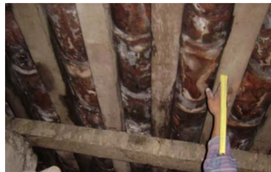
Imagen 39. Tejas alteradas en cubierta del convento. Fuente: Fotografía propia. Archivo Fotográfico Ejercicio profesional Supervisado 2008-2009.
