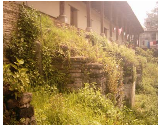
Imagen 32. Alteración en contrafuertes. Fuente: Fotografía propia.
