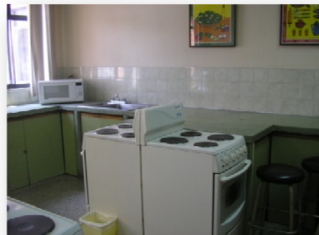
IMAGEN 28. Disposición de estufas en aulas para cocina. Fuente: Elaboración propia.
