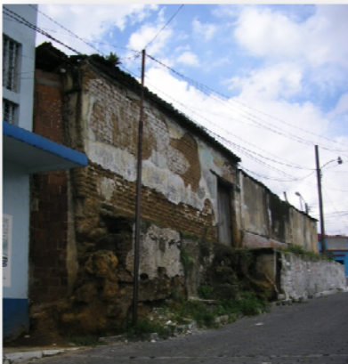
IMAGEN 07. Deterioro. Fotografía tomada en el sector a intervenir, muestra el mal estado en que se encuentran algunas construcciones, deficiencia de banquetas e infraestructura. Fuente: propia.
