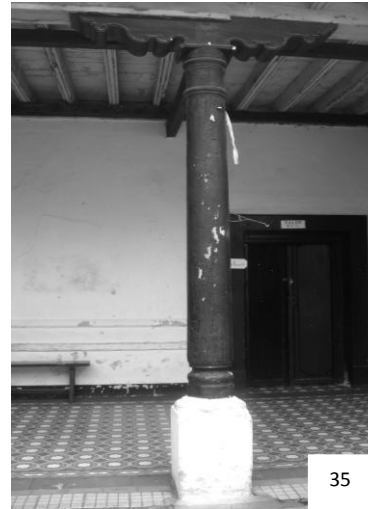
- Imagen No. 35 se muestra que las columnas tienen la forma redonda con un detalle superior llamado Zapata, característico el adorno del estilo Barroco.
