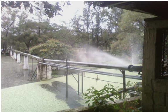
Abastecimiento de agua potable
