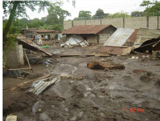
USO MATERIAL DE LA PIEDRA, BLOCK, MADERA Y LAMINA EN LAS VIVIENDAS EL AREA ES DESIGNADA COMO UNA ZONA DE ALTO RIESGO PARA VIVIENDA
