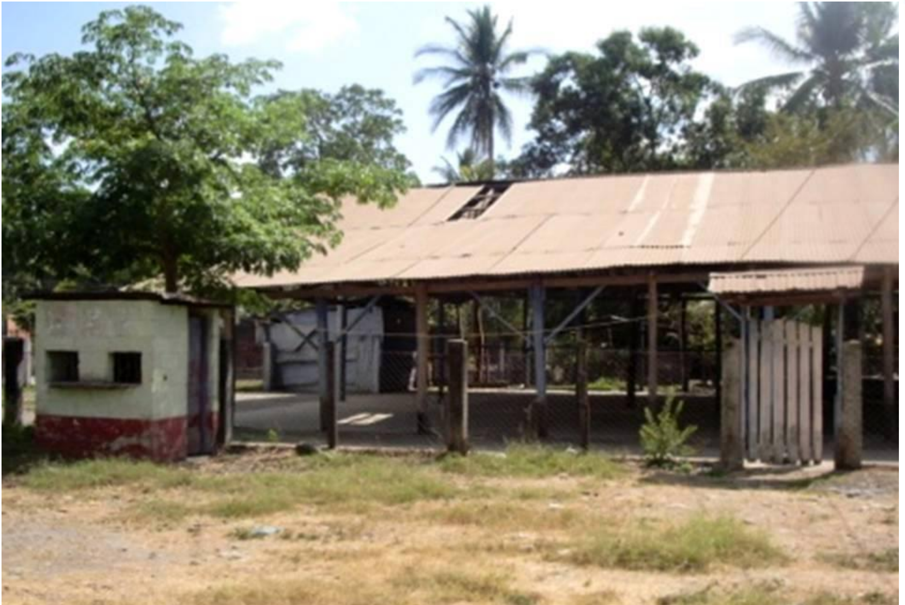
FOTOGRAFÍA NO. 4 Vista hacia el sitio destinado para el Salón Multifuncional. Salón Social Existente en pésimas condiciones
