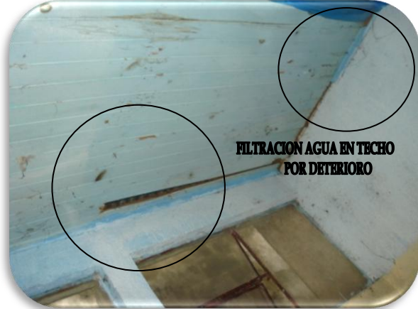
MURO EN MAL ESTADO
