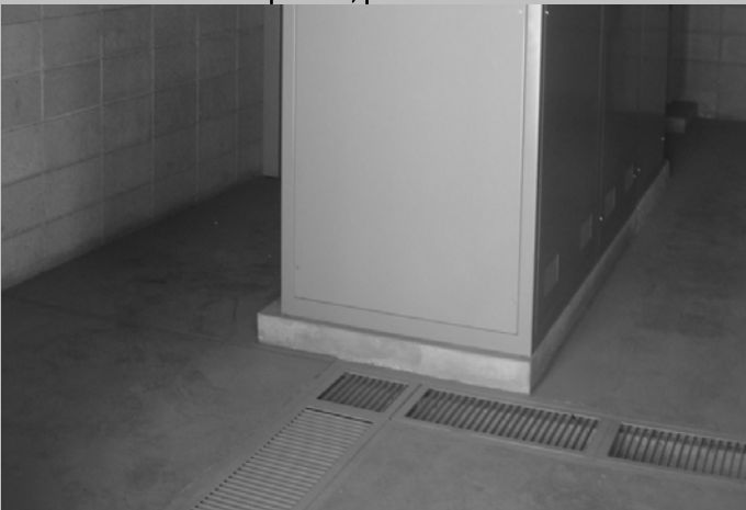
Canaletas con Rejillas, para instalaciones internas
