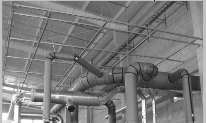
Ductos colgados de la retícula de soportería
