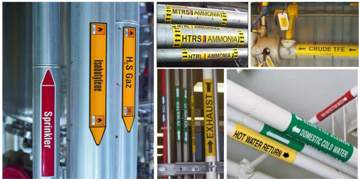
Gráfica 7.28 Ejemplos de señalización en la tuberías Fuente: Imágenes Google, Señalización de Tuberías.
