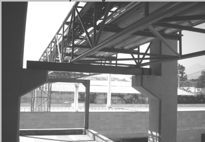
Ingreso de Tuberías a Zona Técnica de Instalaciones
