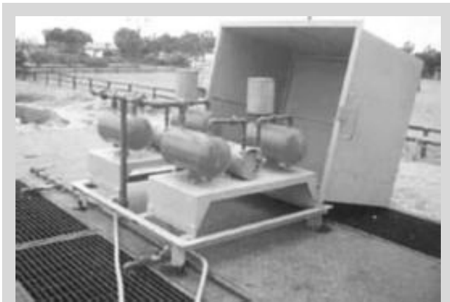
Gráfica 6.37 Planta de tratamiento químico de aguas de proceso industrial.
