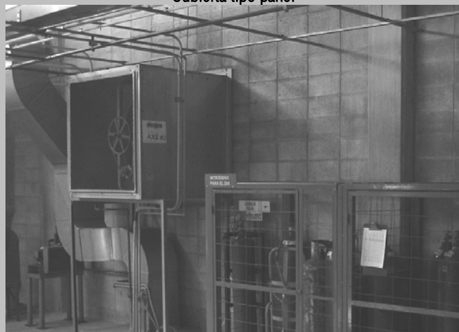
Inyección y Extracción Forzada
