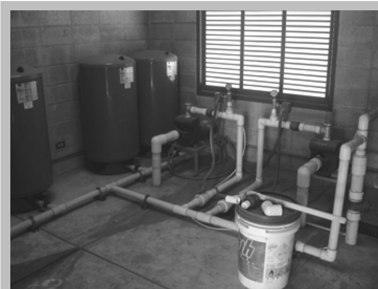
Gráfica 6.1, Sala de bombeo de agua. Fuente: Imágenes Google, Instalaciones Industriales,
