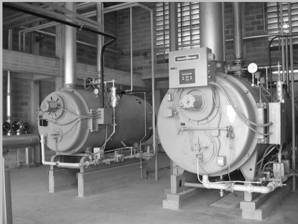
Sala de calderas
