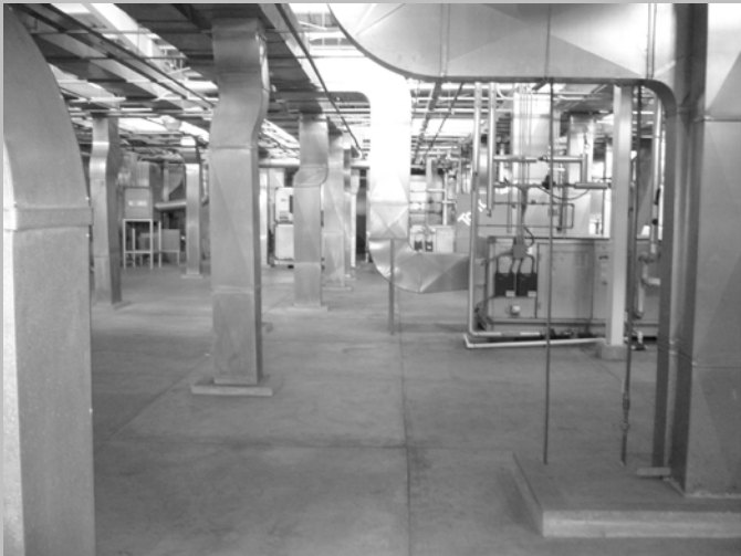
Distribución Ordenada de UTA's en Zona Técnica
