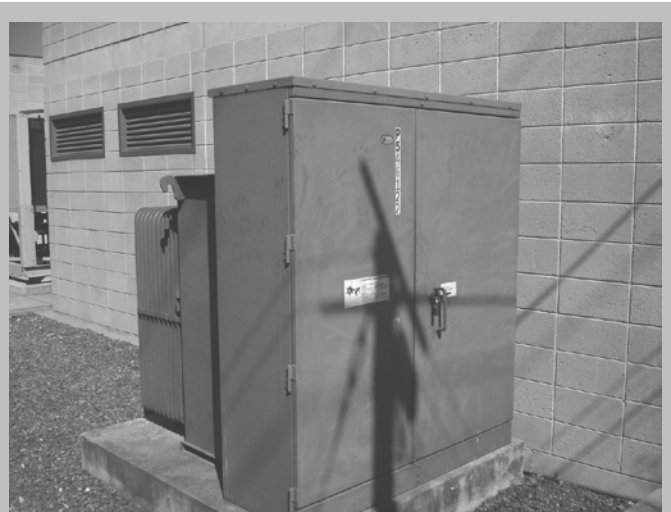
Transformador Tipo Pad Mounted
