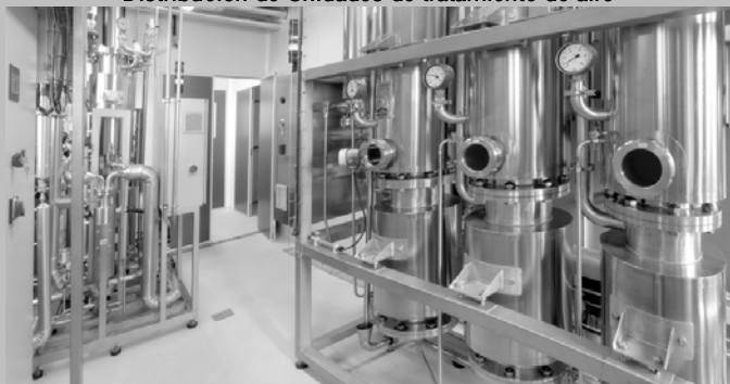
Tratamiento de Agua Destilada
