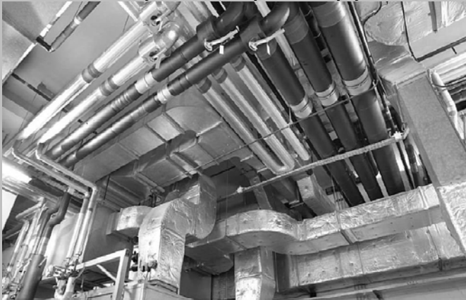
Ducteria y Tubería colgadas
