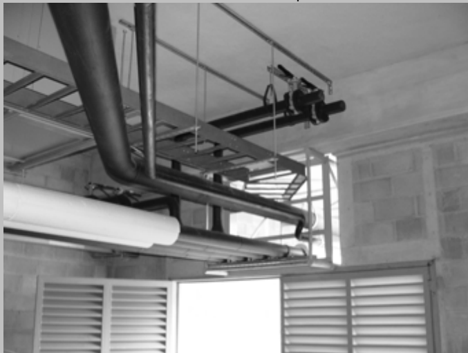
Líneas de Conducción de Vapor y condensados
