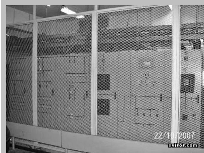
Área de Tableros Eléctricos y Control de Aire Acondicionado
