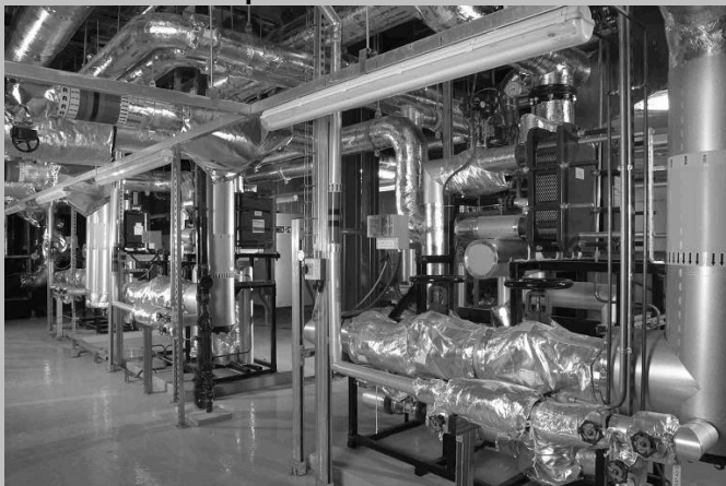
Entrepiso de Instalaciones Total
