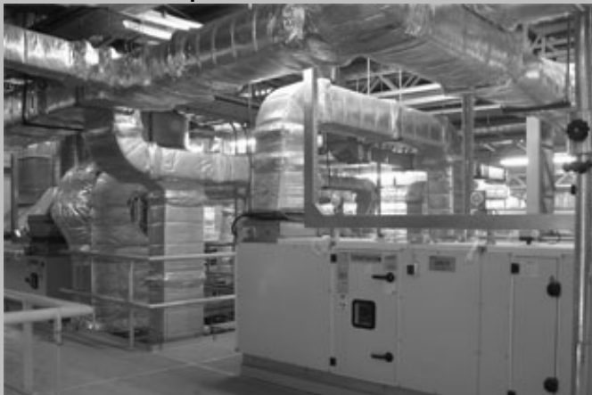
Entrepiso de Instalaciones Total
