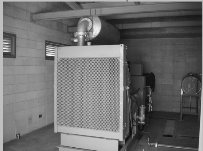
Sala Planta de Emergencia
