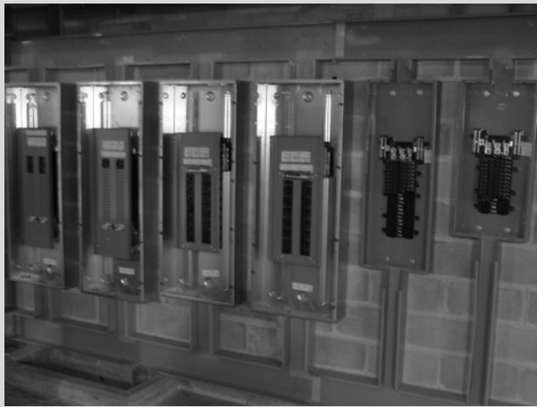
Gráfica 5.53 Paneles Eléctricos en Zona Técnica de Instalaciones Fuente: Fuente: Imágenes Google, Instalaciones Industriales, Laboratorios Bonin, Guatemala
