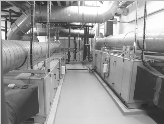
UTA's en Zona Técnica de Instalaciones
