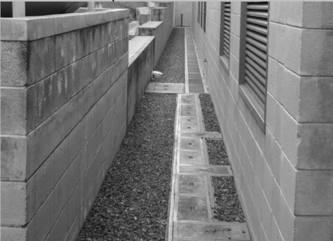
Canaletas con Tapaderas, para instalaciones externas
