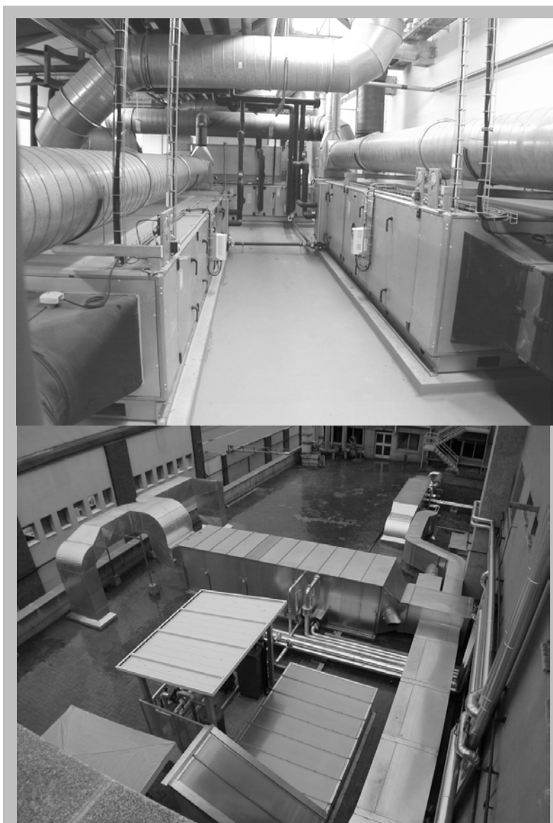
Gráfica 4.38 Arriba, Fotografía de Zona Técnica de Instalaciones Bajo Techo, Abajo Parte de Zona Técnica a Intemperie Fotografías: Proyectos Farmacéuticos, Airplan, España.
