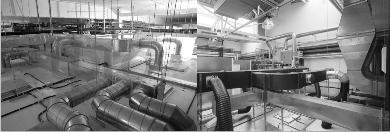
Gráfica 4.41 Imágenes de una Zona Técnica de Instalaciones, Izquierda, aspecto de ordenamiento de servicios y fijación de tuberías mediante cargadores desde la cubierta, Derecha, Iluminación natural y artificial de la zona, Imágenes, Tpro, diseño de salas limpias, www.tpro.com
