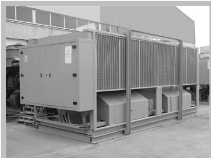
Vista de Chiller (Enfriador de Agua)
