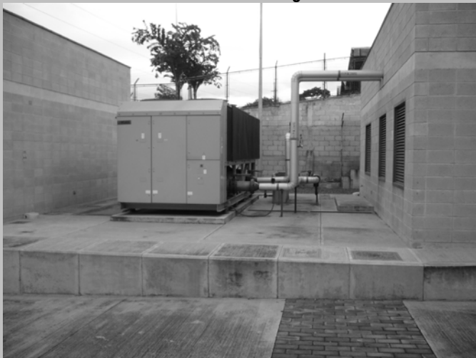
Localización de Chiller en Zona de Servicios
