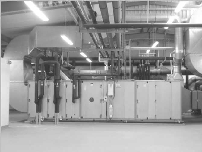
UTA Unidad de Tratamiento de Aire
