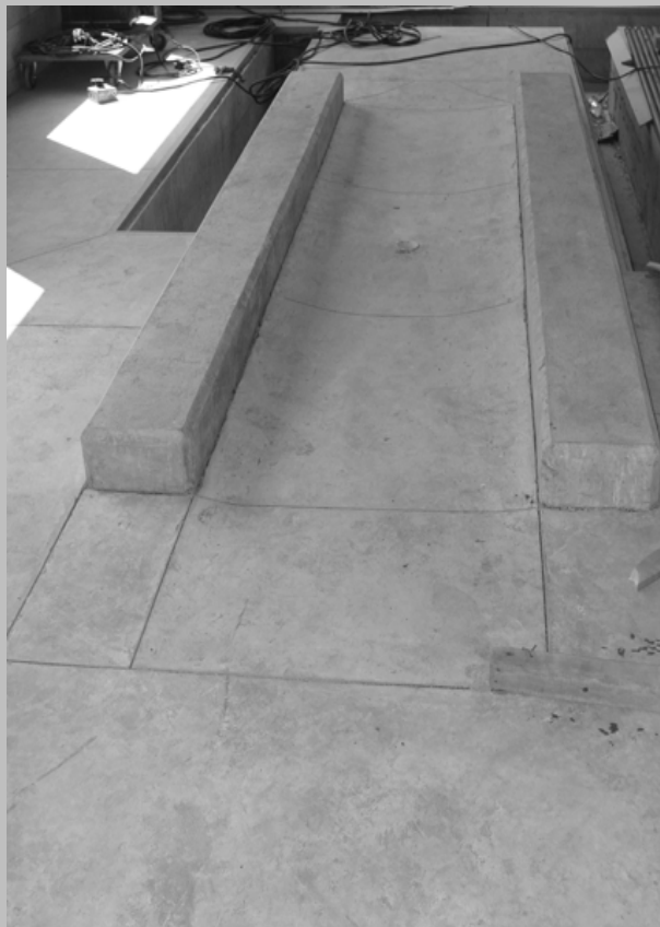
Bases y Canaletas de servicios en salas de caldera
