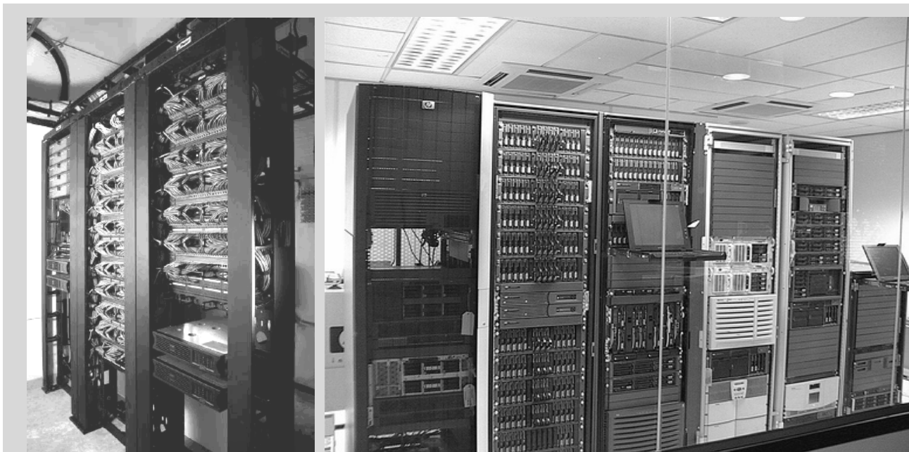
Gráfica 5.46 Cuarto de equipos Fuente: Imágenes Google, Cuarto de equipos.
