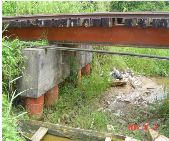
Fotografía No. 19 BASURA DEBAJO DEL PUENTE Fuente. MIRALLES, Edgar
