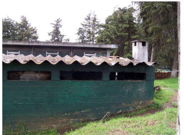
Fotografía 40. Exterior de la cocina, nótese el deterioro de techos y ventanas.
