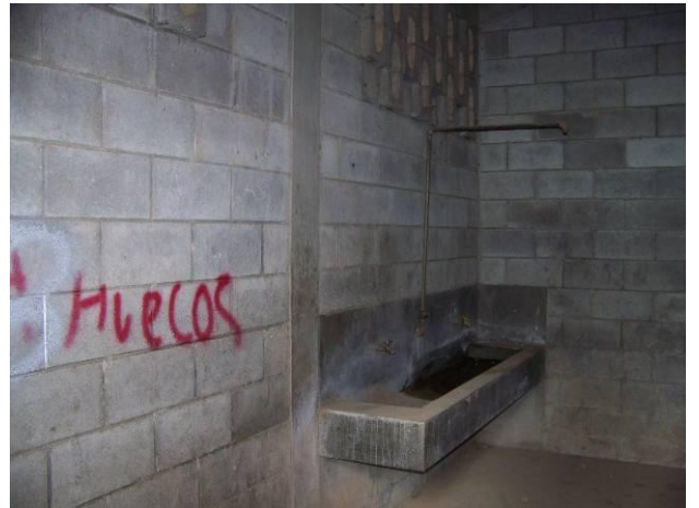
Fotografía 52. Servicios sanitarios de niños también en mal estado, presentando señales de vandalismo.
