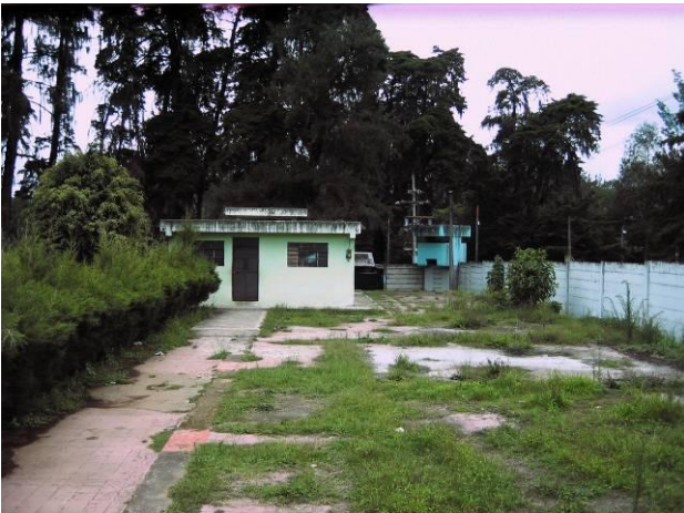
Fotografía 45. Deterioro de las instalaciones.
