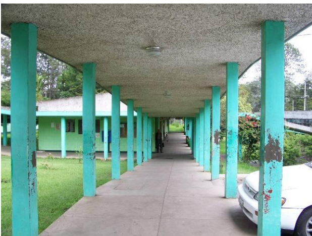
Fotografía 41. Caminamientos techados mostrando ausencia de mantenimiento.
