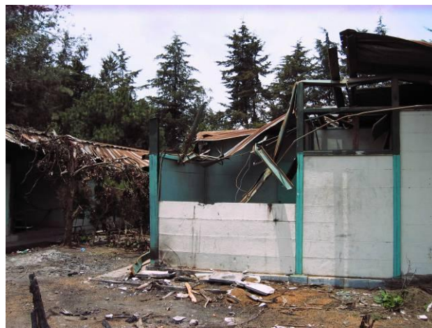
Fotografía 4. Deterioro de las zonas actuales de vivienda escolar.
