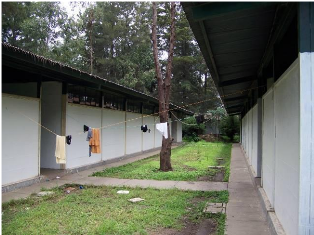
Fotografía 51. Módulos de albergue para internos, no hay lugar apropiado para servicios de lavandería.
