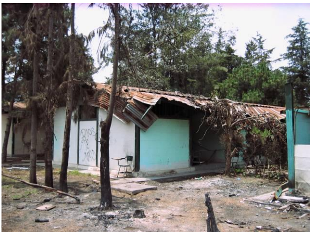
Fotografía 53. Módulos de albergue para internos parcialmente destruidos y en abandono.
