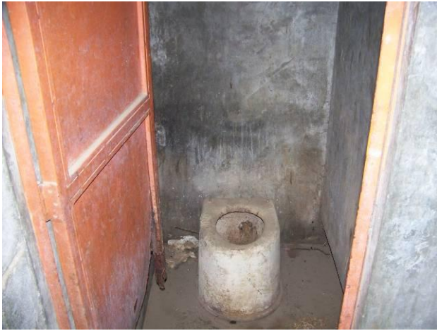
Fotografía 49. Servicios sanitarios de niñas en pésimas condiciones.
