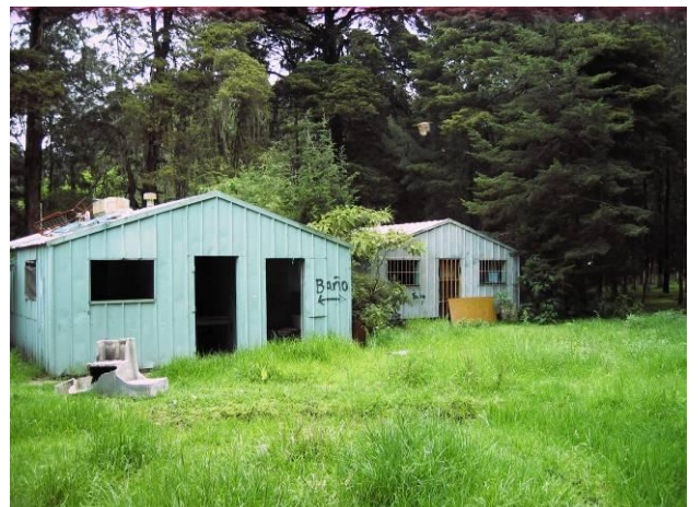
Fotografía 54. Falta de mantenimiento en los servicios sanitarios y sus alrededores.
