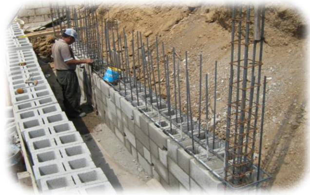
Fig. 18: CONSTRUCCIÓN DEL PROYECTO. La fase de estructuras, es la etapa más extensa en el desarrollo del proyecto, por lo que la programación debe ser bien específica en cuanto al orden de las actividades.
