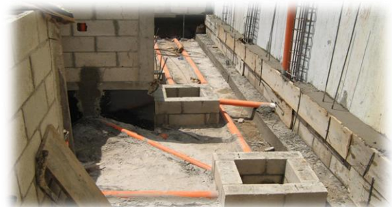
Fig. 23: LOS DRENAJES. Según programación esta fase debe ser combinada con actividades de estructura, según sea el avance del proyecto. De esta manera se reduce tiempo y puede prevenir actividades adicionales.
