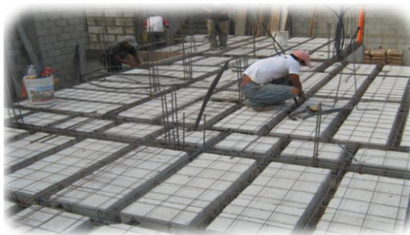
Fig. 20: RENGLÓN DE ENTREPISO: Las actividades en la fase de estructuras se monitorean varias de los cuales las actividades van marcando las etapas del proyecto, logrando así el objetivo deseado en dicha programación.
