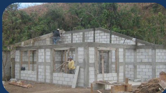
Fig. 51: El proyecto se encuentra a un 100% de muros, las actividades de levantado, encofrado, armado de soleras, y fundición de elemento han sido ejecutados.
