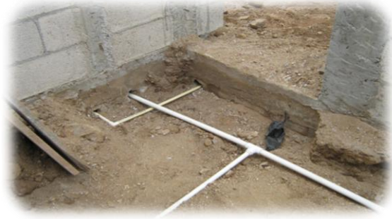
Fig. 26: EL AGUA POTABLE. Según la programación esta fase debe ser combinada con actividades de estructura, según sea el avance del proyecto. De esta manera se reduce tiempo y puede prevenirse actividades adicionales.
