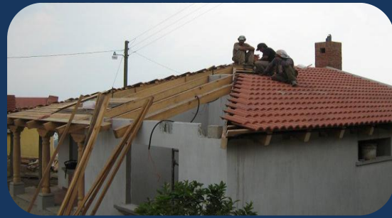
Fig. 55: Colocación de machiambre, colocación de cimbra, colocación de teja, colocación de tubería eléctrica, tratamiento de la madera con asfaltina y sellamiento de juntas.
