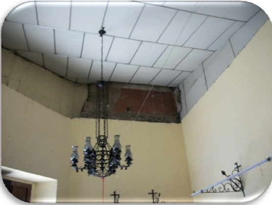
Fotografía 1.6.2 F18 El mal estado de las instalaciones evidencia el poco mantenimiento que se le da.
