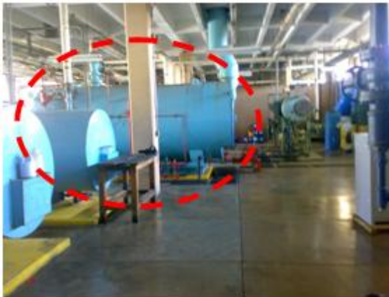
Fotografía No. 6 área de cuarto de máquinas ubicada al sur del solar- Fuente Propia.
