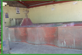
VISTA DE PILA PÚBLICA EN LA ZONA 2
