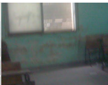
F 1.3.5 Aulas en mal estado
