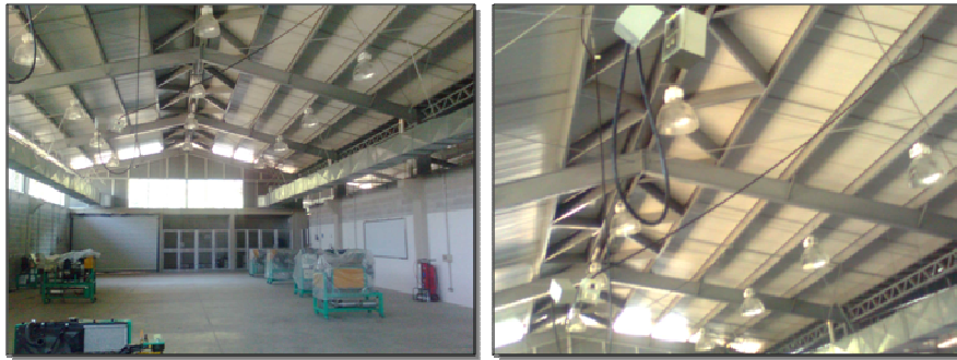
Fotografía No.3 Taller de Mecánica I Fuente: Visita de campo
