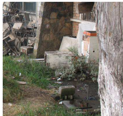
Ilustración 61, Estado actual del servicio Hidráulico. Por Mario Castillo.
