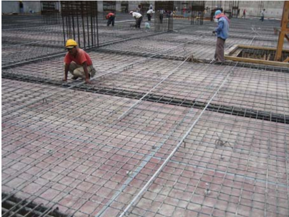
Imagen No. 14 Fuente: Fotografía edificio Design Center, Guatemala Descripción: Armado de losa
