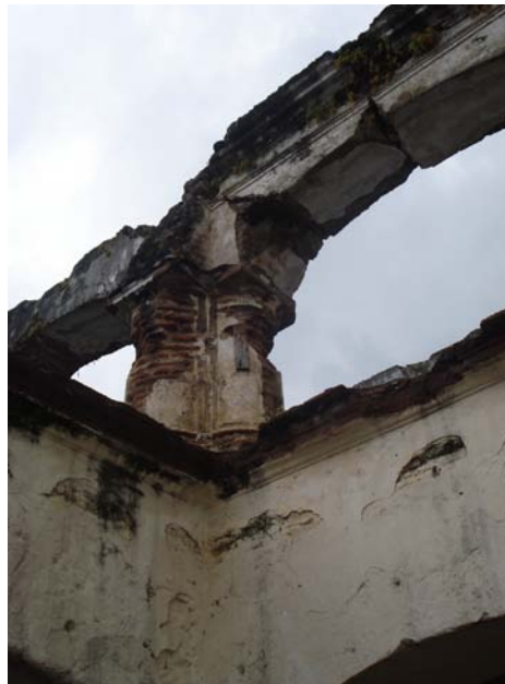
Fotografía 79. En el área del segundo nivel del Convento se observa la existencia de una arcada, la cual muestra serios daños, lo que compromete la estabilidad, y permanencia de dicho elemento.
