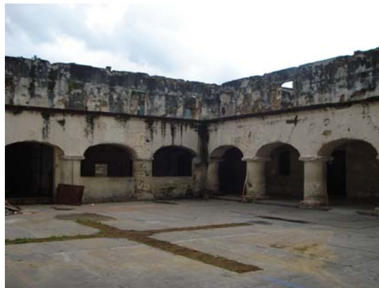
Fotografía 81. Vista del convento de Santa Teresa de Jesús desde el patio principal, observando los daños y alteraciones que ha sufrido. Fuente: elaboración propia, año 2008.
