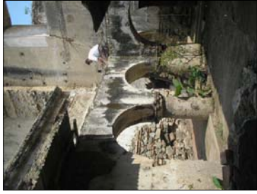
FOTOGRAFÍA No. 10: AL SALIR DE LA SACRISTIA EXISTE UN PATIO, DONDE SE OBSERVA AUN LA ARCADIA ORIGINAL SOBRE LA DESCANSABA LA CUBIERTA DEL CORREDOR.
