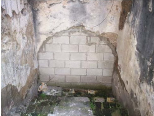
Fotografía 73. Vanos tapiados, con block y otros materiales.
