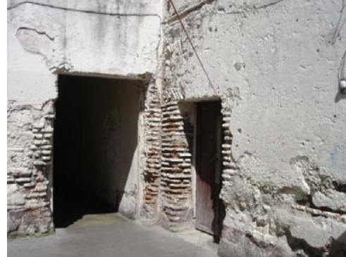
Fotografía 66. Daños en muros, por disgregación de materiales.
