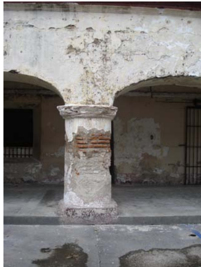
Fotografía 61. Se observa en el área del primer nivel el grado de deterioro de las columnas, siendo visible la pérdida de material compositivo, y de aplanados. Fuente: elaboración propia, julio 2008.
