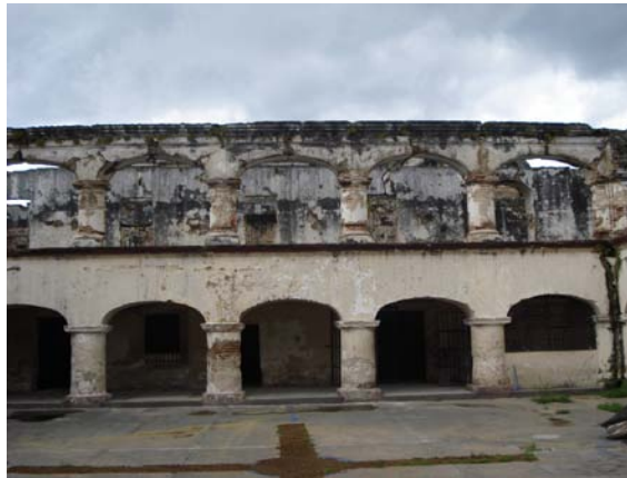
Fotografía 46: arcadas en el área de los corredores ubicados al sur, del primer y segundo nivel del claustro. Fuente: elaboración propia. Agosto 2008
