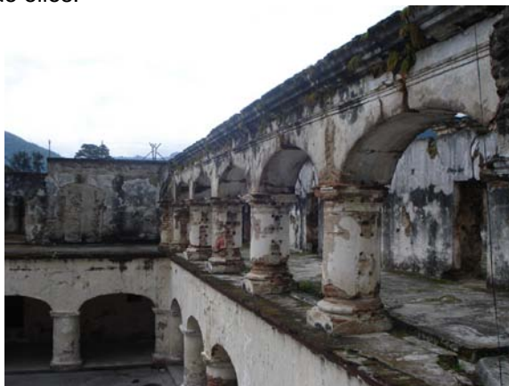
Fotografía 58: vista del área sur del convento, siendo visibles daños y alteraciones en el monumento.
