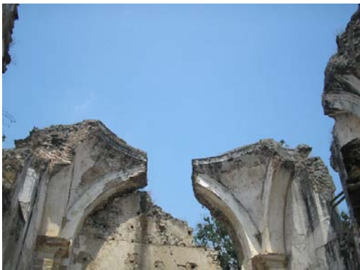
Fotografía 67. El templo carece de cubierta.
