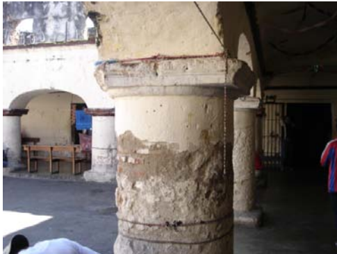
Fotografía 65. Daños en columnas, pérdida de material compositivo y de aplanados.
