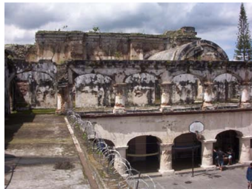
Fotografía 68. El segundo nivel del claustro actualmente no cuenta con cubierta.
