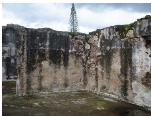
Fotografía 64. Se observa la pérdida de aplanados, y el crecimiento de microorganismos en los muros.
