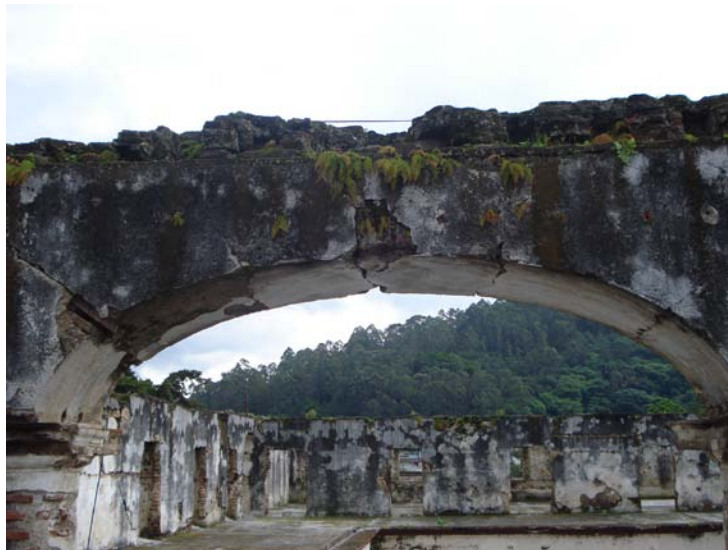
Fotografía 57: vista del segundo nivel del convento donde se observa la falta de las ventanas y las puertas. Fuente: elaboración propia, enero de 2010.
