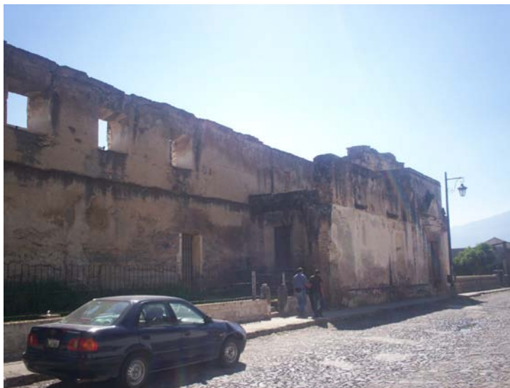
Fotografía 80. Se observa que el convento carece de cubierta lo que ha generado el debilitamiento de los muros. Fuente: elaboración propia. Mayo 2008.
