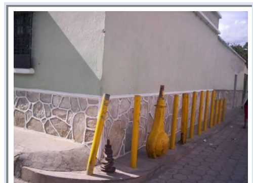
Imagen 6 Obstrucción de acera. Fuente: Propia, 2009.
