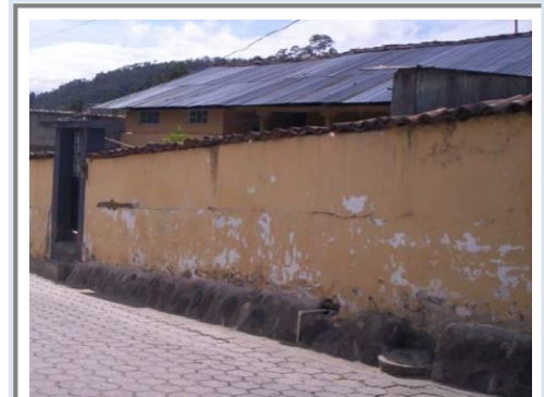
Imagen 4 Alineación sin banqueta. Fuente: Propia, 2009.
