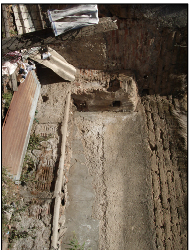
VISTA LATERAL DE CAJA DE AGUA
