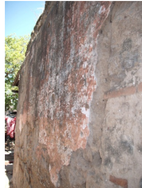
Muros de materiales y sistemas Constructivos de la época colonial. fuente: Pablo González 2009.
