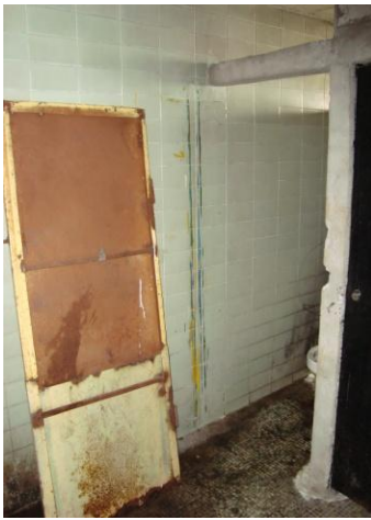
Fotografía 4: Muestra el mal estado del mobiliario en cada uno de los sanitarios.
