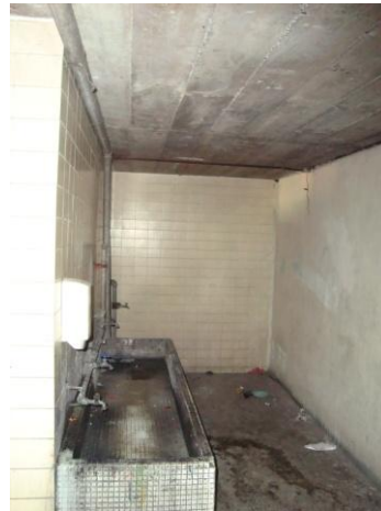
Fotografía 5: Muestra la falta de iluminación e higiene en las áreas de lavamanos.
