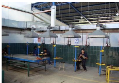
Fotografía 10: Muestra las áreas de electricidad industrial.
