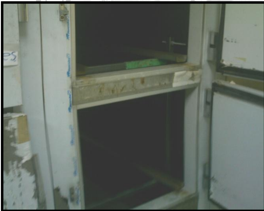
Fotografía 12: "Área de Frigoríficos" Fuente Propia.
