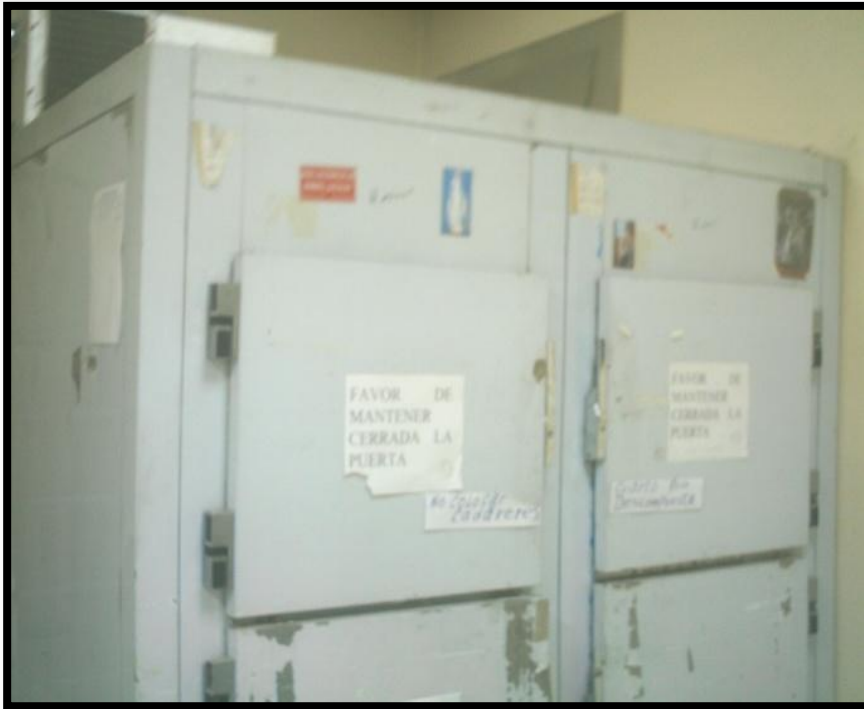
Fotografía 11: "Área de Frigoríficos" Fuente Propia.
