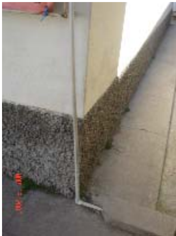
Fotografía No.8: Instalaciones de agua potable improvisadas. Elaboración Propia.
