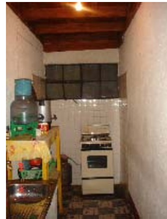
Fotografía No.2: Inadecuada utilización de los ambientes, (utilización de servicio sanitario, como cocineta). Elaboración Propia.
