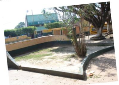
FOTO No. 5 Observamos que el área verde y jardines internos se encuentran secos por falta de mantenimiento o del ornato, a su vez el piso del parque se encuentra en muy mal estado. Al fondo se observa la municipalidad del municipio que se encuentra ubicada cerca del parque.
