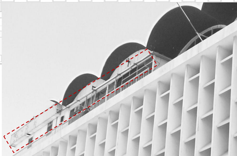
Imagen No. 38 [Alteraciones, Edificio TELGUA Central] Autor: E. Suárez Reynoso Fecha: 09/02/2010
