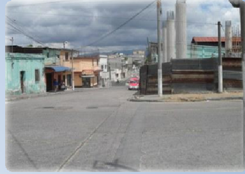
Esquina de la primera avenida con la 18 calle, zona 3, construcción de la fase dos del edificio de la estación central de bomberos.
