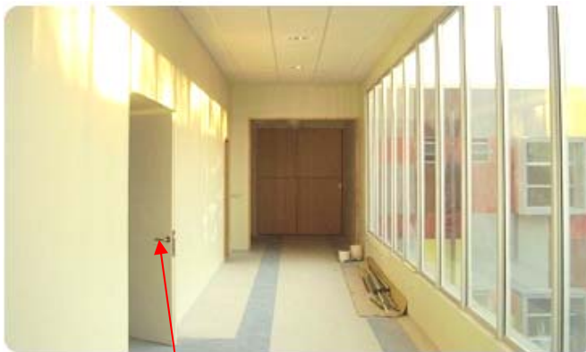
Abatimiento incorrecto de puerta, presenta peligro Imagen 16 Pasillo Fuente: Pie de página 22
