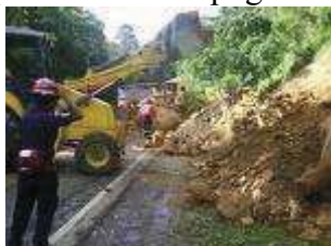
FOTOGRAFÍA N° 17: derrumbe en cuesta de las Cañas.
