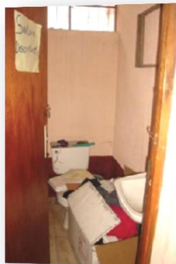
Fotografía 46, Servicio Sanitario de usuarios del Centro de Salud de San Juan Ostuncalco, Quetzaltenango
