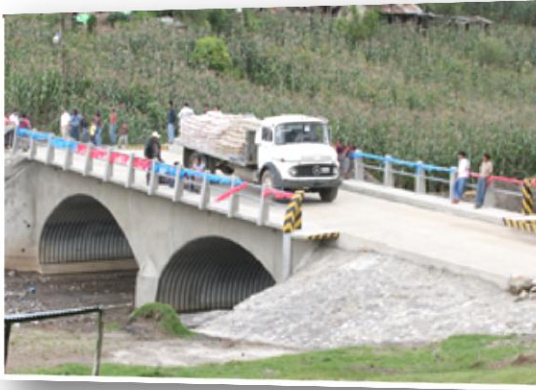
Fotografía 38, Puentes deteriorados en San Juan Ostuncalco, Quetzaltenango.
