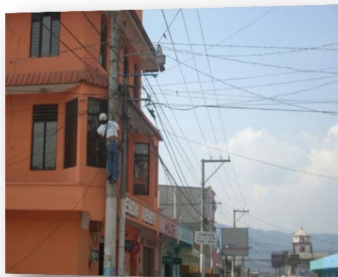
Fotografía 33, Saturación de cables de energía eléctrica en San Juan Ostuncalco, Quetzaltenango
