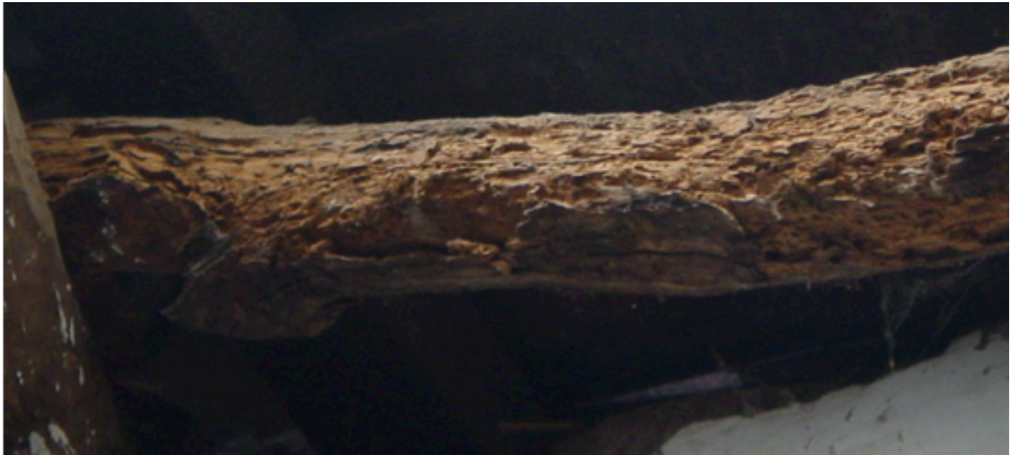
Deterioro causado por insectos en el soporte de la cubierta.
