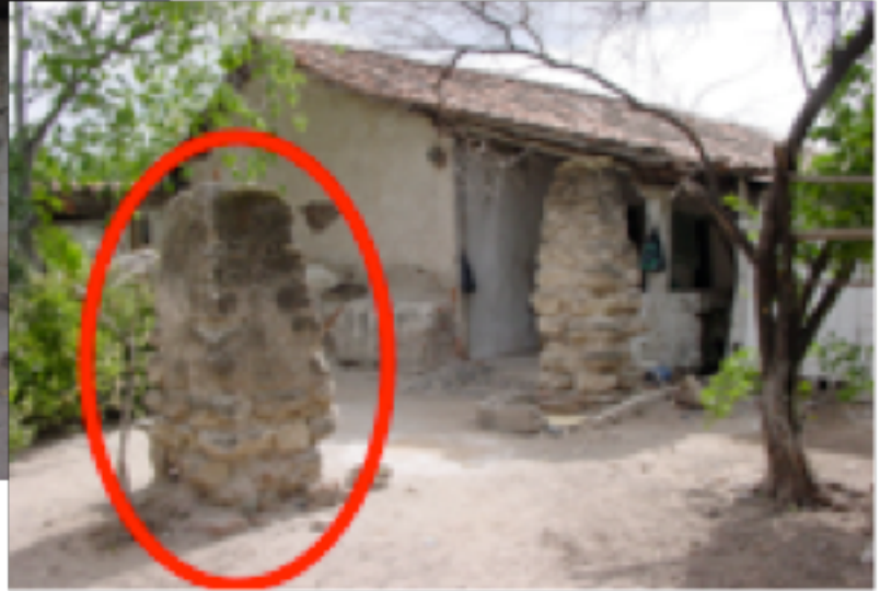
Columna derribada en marzo del 2005.
