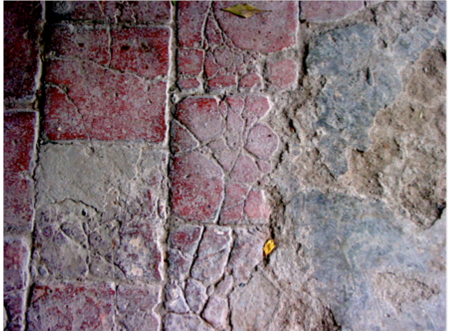
Capa de cemento agregada al piso, que solo significó un arreglo poco duradero.
