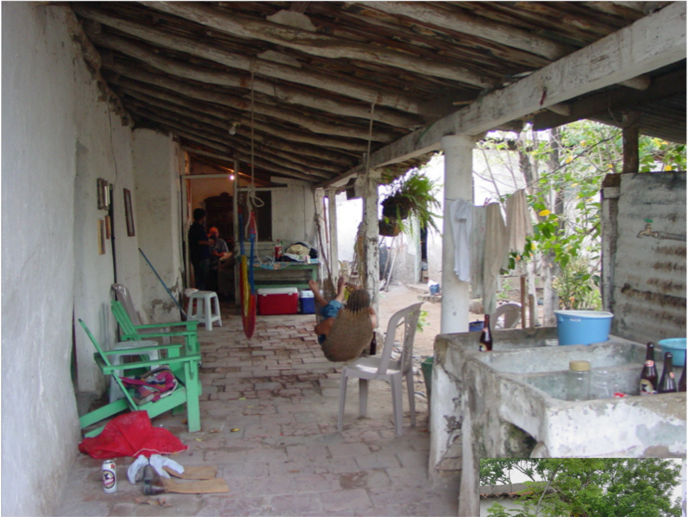
Desplome en las columnas del corredor.
