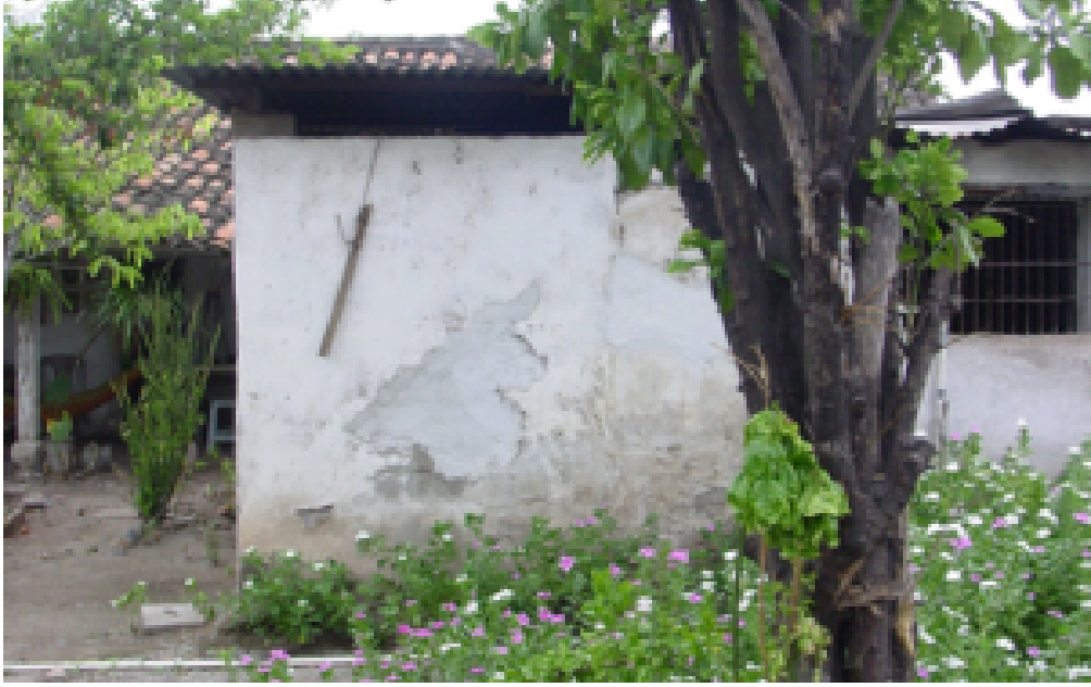
Vista posterior del baño. Obsérvese la grieta formada en la unión del muro de block de cemento con el muro de adobe.
