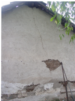
Grieta en el muro occidental.
