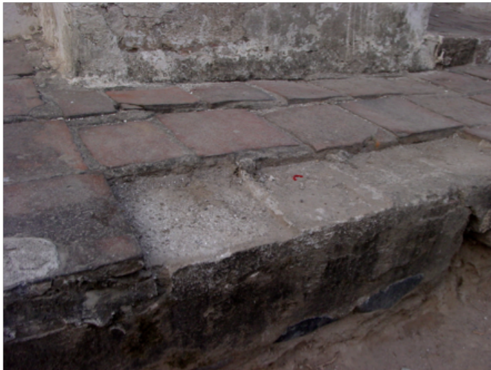
En el exterior de la vivienda es en donde más se observa el faltante de pisos, debido al uso tanto de la familia como de personas ajenas que buscan la comodidad de los poyos.
