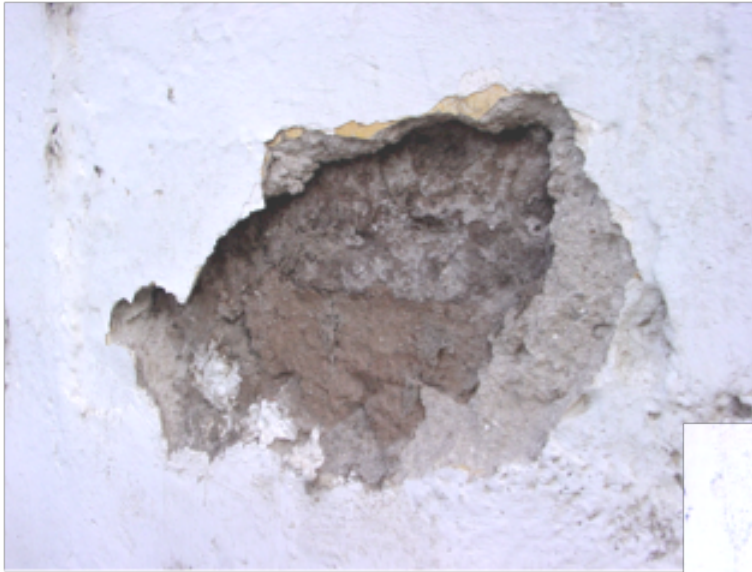
Faltante de aplanado en el frontispicio.
