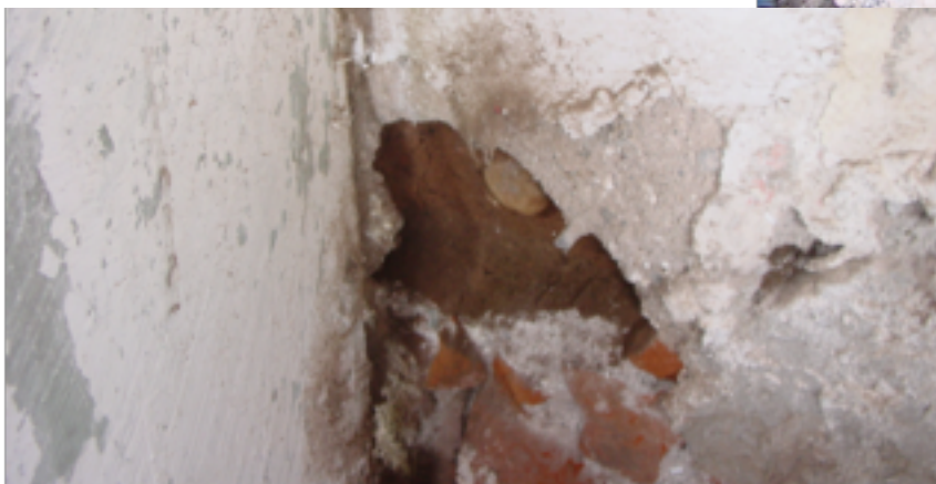
Faltante en el frontispicio, junto al poyo occidental.
