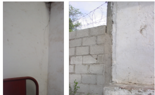
Grieta en la junta del muro norte y el muro oriental, vista desde adentro y desde afuera.
