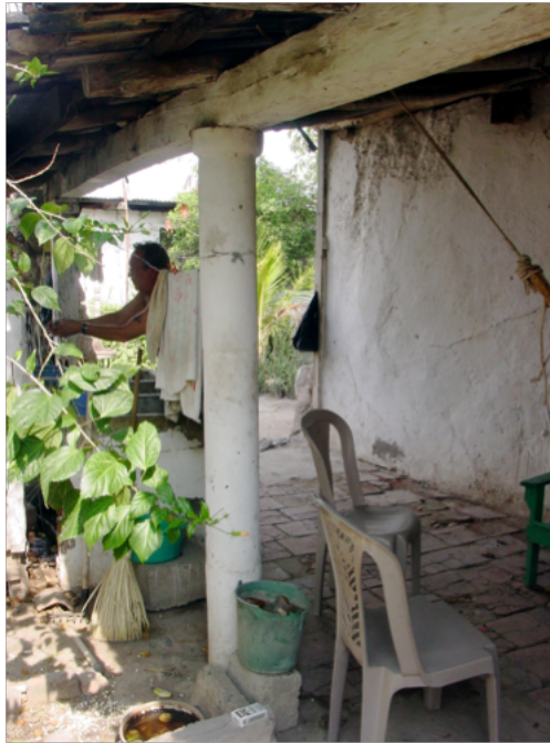
Columna improvisada con tubos de desagüe.
