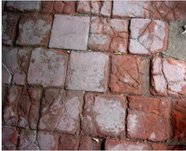
Baldosas deterioradas en el corredor, al igual que en toda la vivienda.
