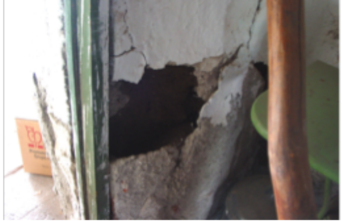
Faltante en el muro sur de la habitación oriental
