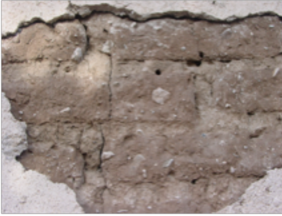
Faltante en el exterior del muro occidental.
