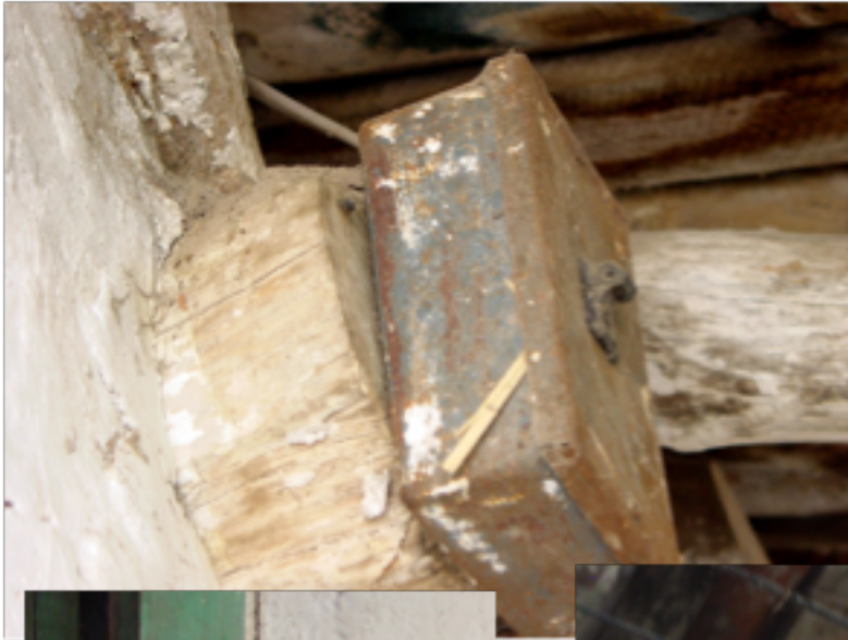
Instalaciones eléctricas riesgosas que pueden ocasionar incendios.
