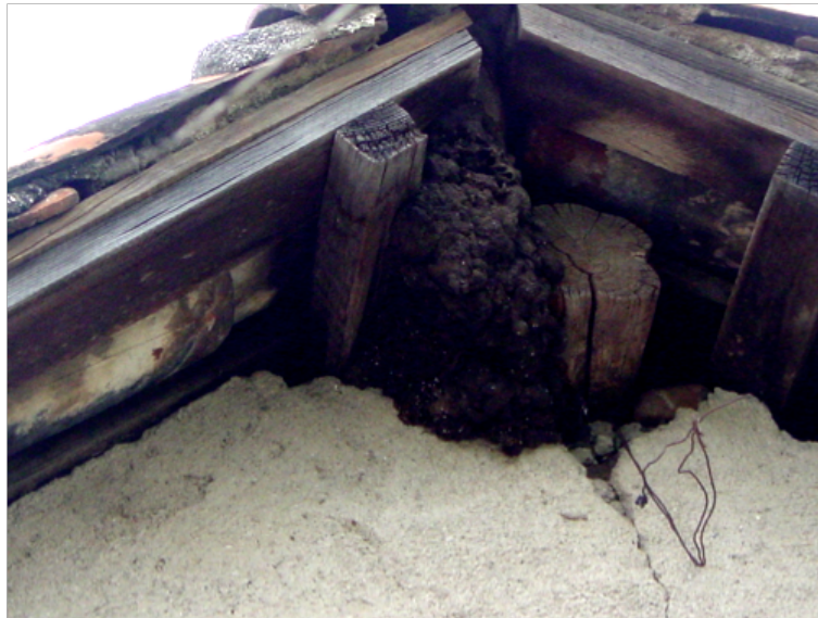
Panal de abejas, en el muro occidental y el techo de la vivienda Barrientos Morales.
