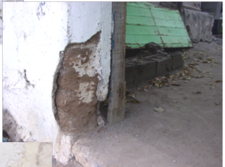
Faltante en la puerta de entrada al patio.
