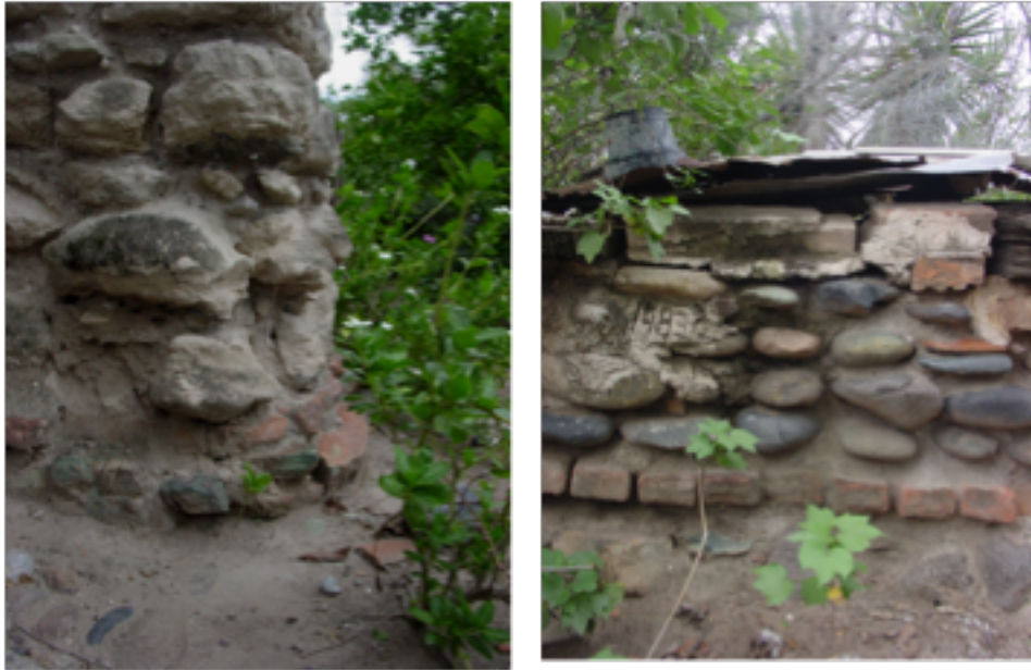
Faltante de repellos en la columna, a la izquierda y brocal del pozo.
