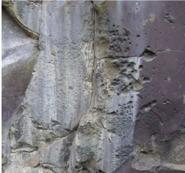
Figura 23: Vista de alveolización debido a la erosión del viento y de depósito de capa arcillosa en las concavidades.
