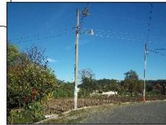
FOTOGRAFIA 13 ENERGIA ELECTRICA EXISTENTE ACOMETIDA 120/240 V.
