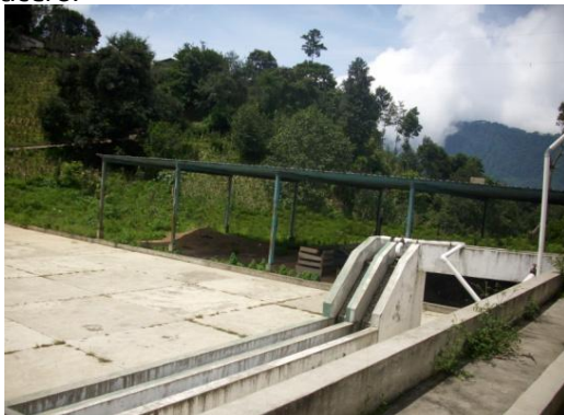
FOTOGRAFÍA 53. Canales para el correteo, se observa los canales que llegan hasta el patio de secado, se observa la falta de mantenimiento en todas las instalaciones del beneficio.
