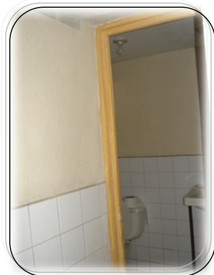
Muro de block + azulejo, se recomienda la utilización de materiales fáciles de lavar. Fotografía #50, elaboración propia del investigador
