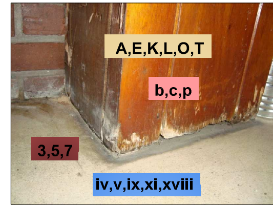
Fotografía No. 20 COLUMNA RECUBIERTA CON MADERA, MORGUE Autor: Dunia Mariela Navarro Mérida
