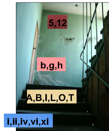
Fotografía No. 24 ESCALERAS DE EMERGENCIA INHABILITADAS Autor: Dunia Mariela Navarro Mérida
