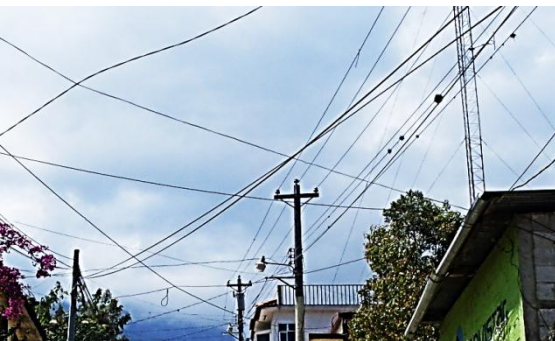
Fotografía. No.33 Cableado Aéreo Fuente: Elaboración propia, 2010
