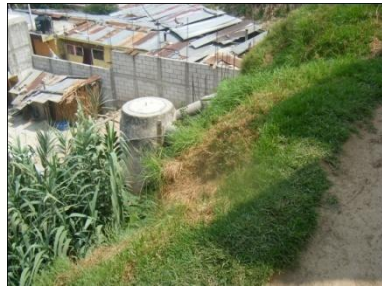
Fotografía No.9 Candelas de aguas negras
