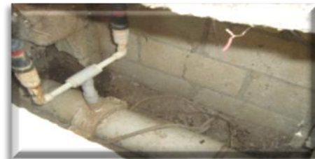
Fotografía 34: tubería de pozo de agua potable, perteneciente al pozo. 14
