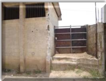
Foto No. 3 El ingreso no cuenta con un área específica de parqueo para carga y descarga.
