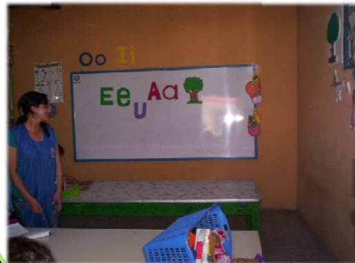
Fotografía 2, interior de los ambientes, carente de ambientación por medio del color. Debido a las condiciones físicas del edificio no se tienen espacios suficientemente grandes para la atención de los niños. Fuente: Del autor
